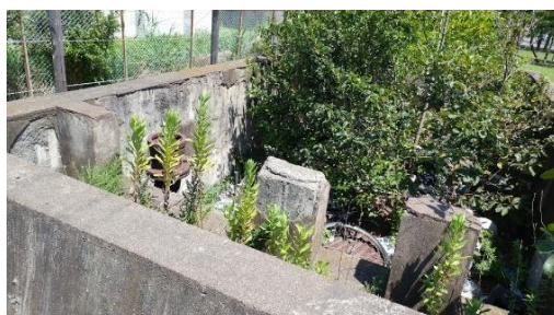
▶老朽化した建造物
